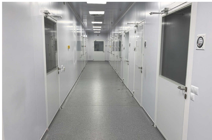
Комплекс чистых помещений для АО «Нижфарм»
